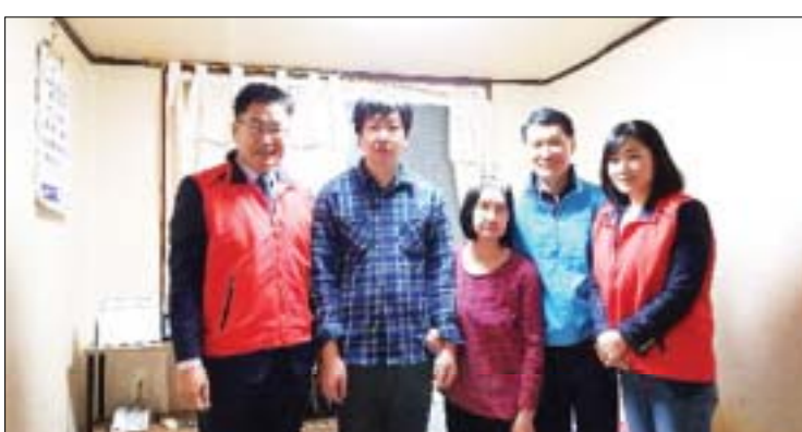
유등노인복지관, 서구 도마동 저소득가정에 LED전등 교체 유등노인복지관은 28일 서구 도마동 저소득가정 30여가구 대상으로 LED전등교체를 실시했다. 박명래 관장은 "우리 주변에 생활이 어려운 분들의 주거 환경을 개선하고 전기요금절감 효과도 거둘 수 있고 대상자에게 한발더 다가가는 계기가 될 것으로 기대 한다"고 말했다.
